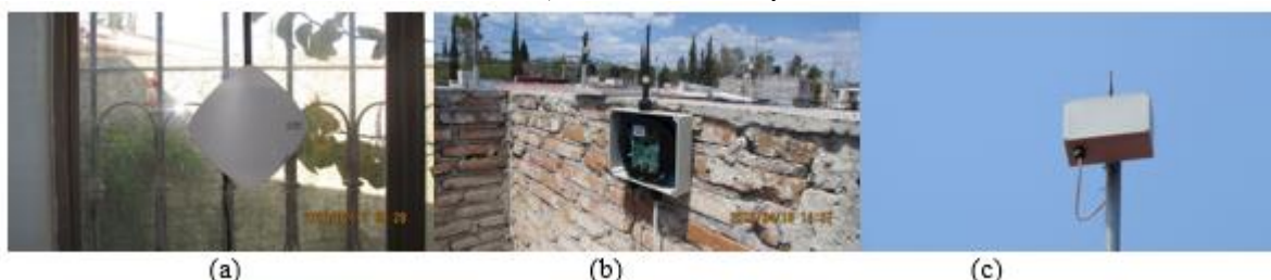
Figura 1. Instalaciones previas del gateway, a) interna, según indicaciones del fabricante, b) externa, junto a un muro en la azotea de una vivienda, c) externa, sobre un poste metálico de 5 m.
