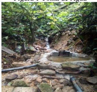
Figura 1 Toma de Agua
